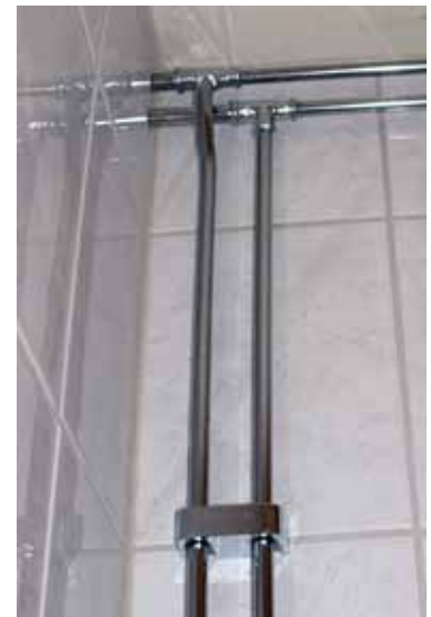
Taloyhtiön asukkaiden mielestä kromattujen kupariputkien sirous ja pienikokoisten puristusliittimien ulkonäkö ovat putken kestävyys ohella hyvin tärkeitä valintaperusteita.
